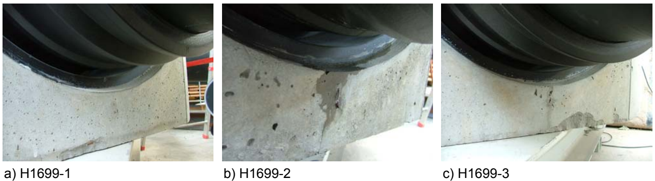
Bild 27: Übergang vom Schacht zum PE-Adapter an der Rohrunterseite während der Dichtheitsprüfung nach dreimonatiger Beanspruchung
