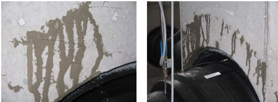
Bild 11: Schachtanschluss H1699-7: Abwinklung von 97 mm/m bzw. 5,5° (156 mm am Rohrende), Rissbildung im Beton und tropfender Wasseraustritt durch den Beton
