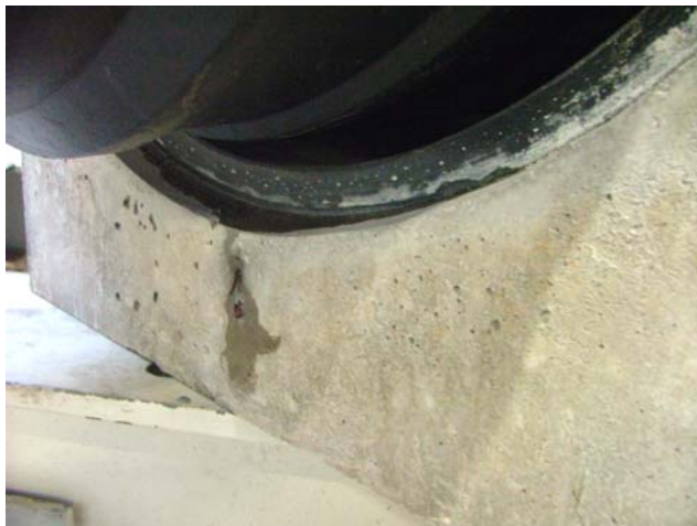
Bild 21: Feuchtigkeit im Beton unter dem Schachtanschluss H1699-2 bei Beginn der Langzeit-Abwinklungen
