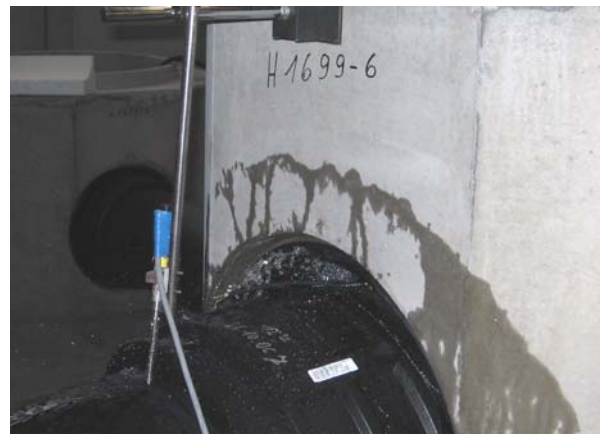
Bild 10: Schachtanschluss H1699-6: Abwinklung von 121 mm/m bzw. 6,9° (194 mm am Rohrende), Versagen des PLASSON Schachtanschlusses
