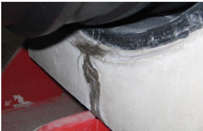
Bild 9: Schachtanschluss H1699-6: Abwinklung von 66 mm/m bzw. 3,8° (107 mm am Rohrende), leichte Durchfeuchtung bis leicht tropfender Wasseraustritt durch die Schachtwand
