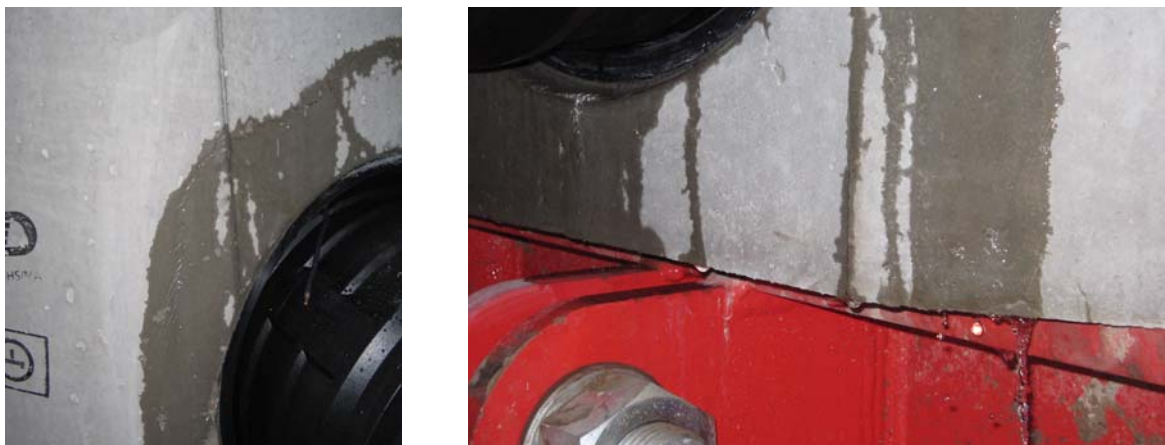
Bild 12: Schachtanschluss H1699-7: Abwinklung von 113 mm/m bzw. 6,4° (181 mm am Rohrende), Rissvergrößerung und stark fließender Wasseraustritt durch den Beton sowie am Übergang zum PE-Adapter über den gesamten Umfang
