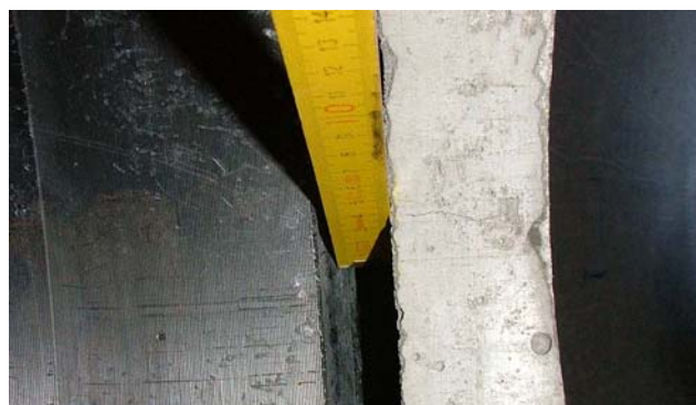
Bild 25: Verformungen am PLASSON Schachtanschluss, Blick auf den Scheitel des Anschlusses
