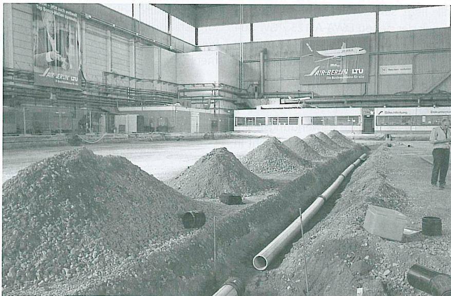
Gefordert war, den Kanal im Hangar flüssigkeitsdicht herzustellen. Deshalb wurde mit Plasson LightFit ein vollverschweißtes Abwassersystem aus Polyethylen verlegt.
