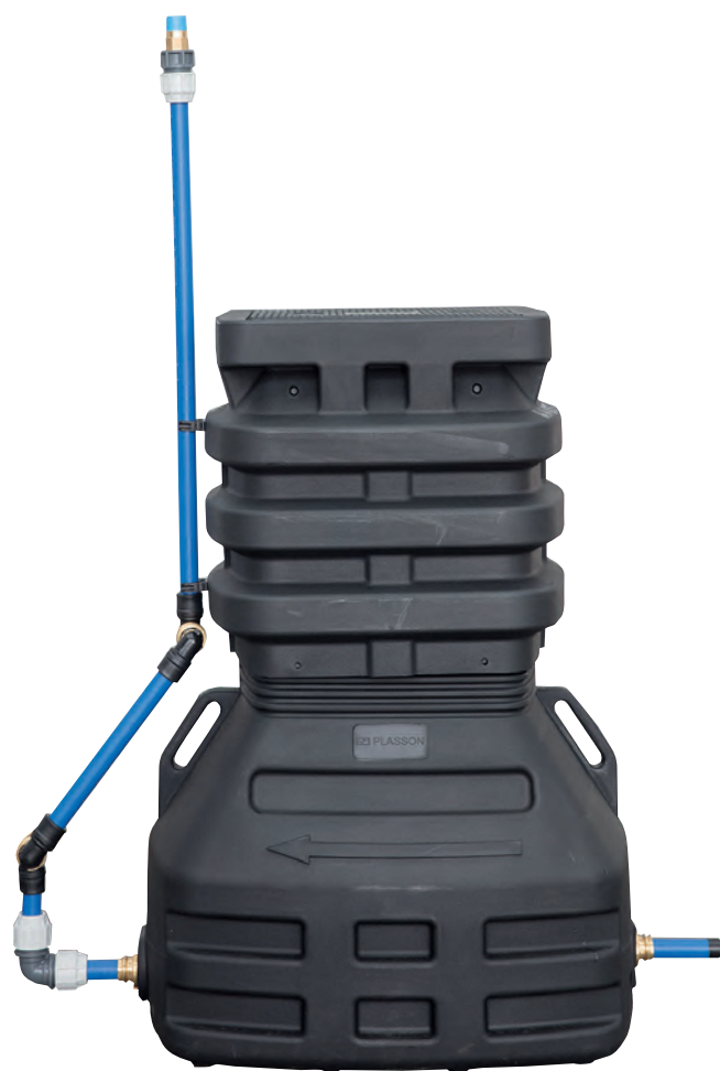
Wasserzähler-Schacht mit montiertem Leitungspaket für den Bauwasseranschluss
