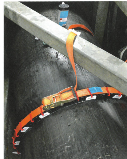
Abb. 3 – Die Flex-Fixierblöcke wurden der Reihe nach auf einen Spanngurt aufgefädelt und der Spanngurt um das Rohr gelegt.
