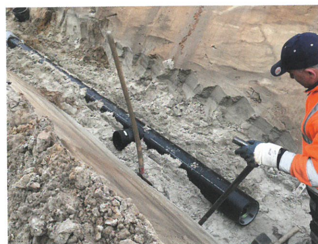
Bild 1: Erschließung Wohngebiet „Landwehrviertel“: Das neue Schmutzwasserkanalnetz besteht aus verschweißten PE-Kanälen mit einer Länge von über 7 km
