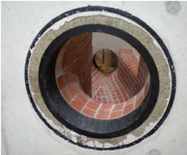
Bild 3: Werkseitig integrierter PLASSON-LightFit-Betonschachtadapter und Schachtanbindung
